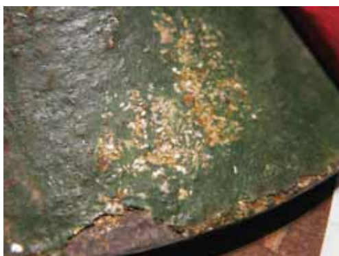
Détail d'une zone usée des toitures laissant apparaître les paillettes du fond aventurin
