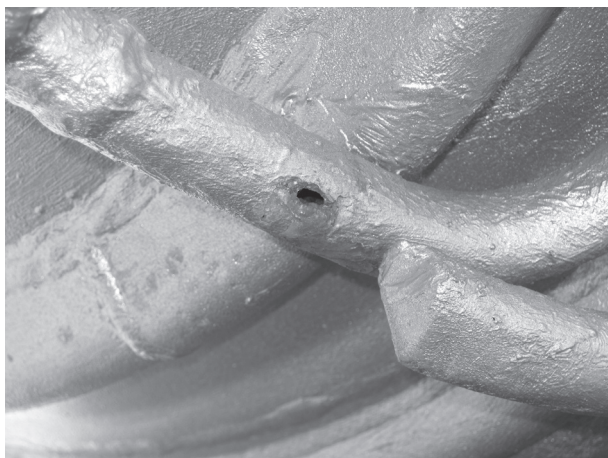
Gladstrijken van het poreuze oppervlak met polyester. Verzwakt buizensysteem. Nieuwe roestsporen.
